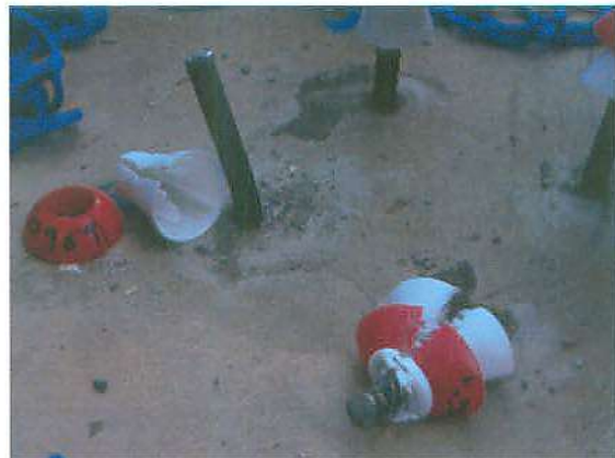
Fotografía 15: Perforaciones totales y roturas longitudinales de las protecciones
