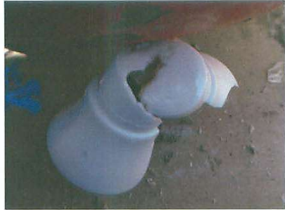
Fotografía 13: Detalle del estado de una de las protecciones que ha sufrido el impacto
